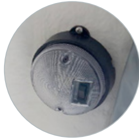
Innenbeleuchtung (nicht blendend)
